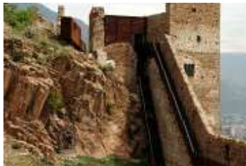
Einbauten wie die Stahltreppe sind so gestaltet, dass sie problemlos zurückgebaut werden können, um die Burg in den Urzustand zurückzusetzen © Jens Maier
